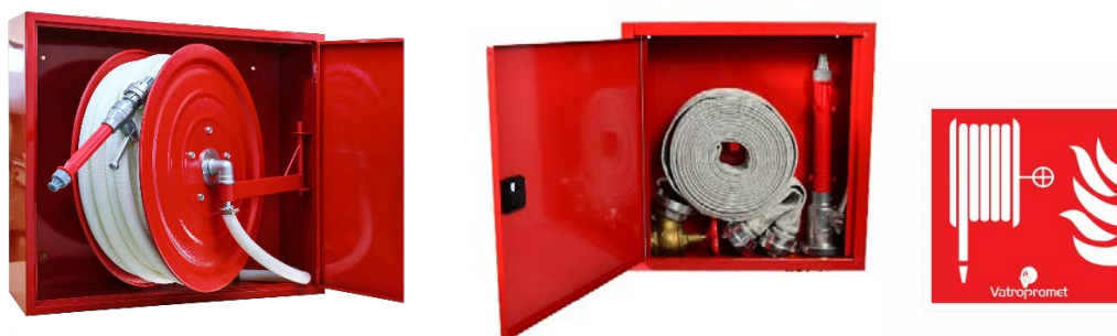
Primjeri ormarića unutarnje hidrantske mreže te njihovo pravilno označavanje sigurnosnom oznakom
